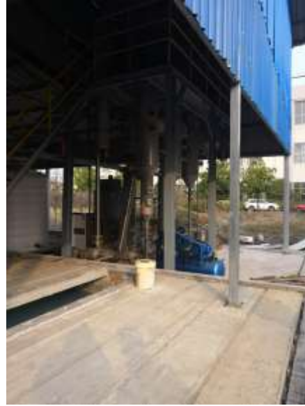
三效蒸发装置
