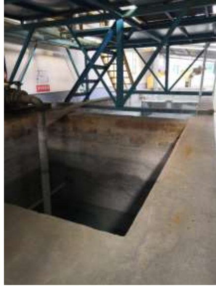
污水处理设施（混凝+沉淀）
