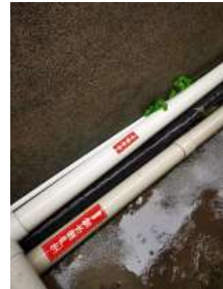
生产废水管道
