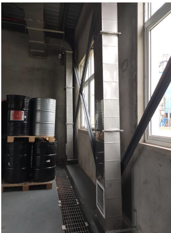
废气收集管道
