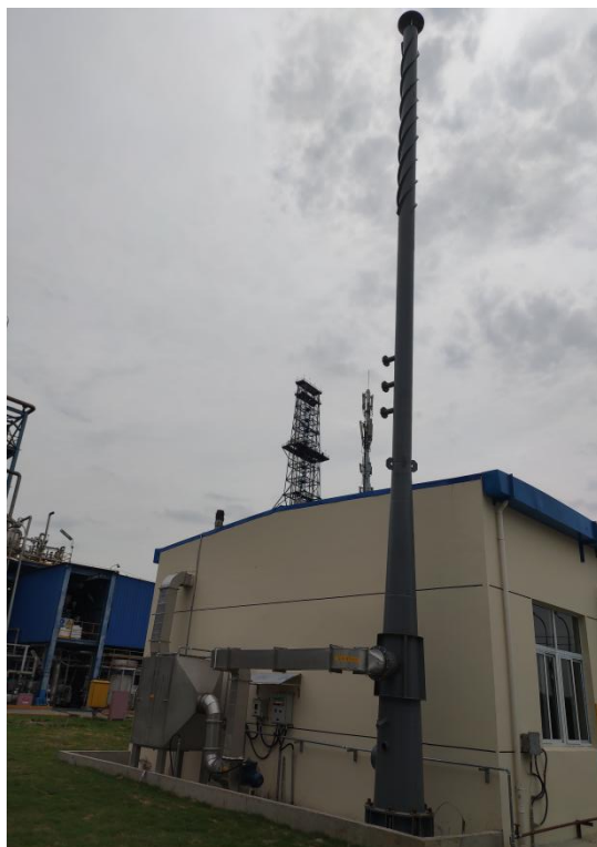
活性炭吸附装置及排气口
